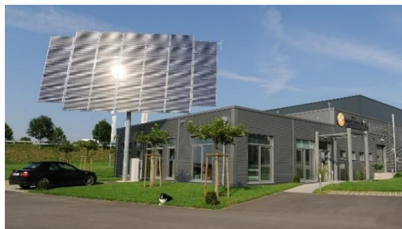
PV / Photovoltaik Solar Tracker im Einsatz
